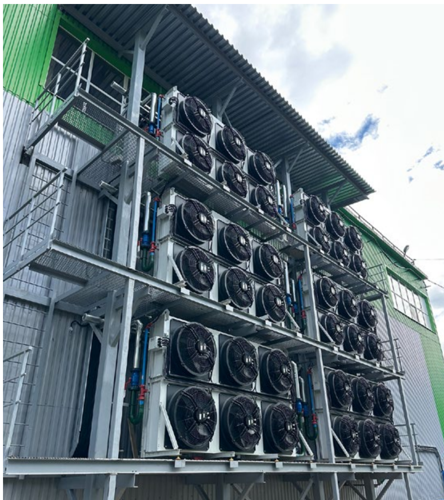
❖ «Стена холода» — шесть вертикальных драйкулеров NCT с адиабатическим охлаждением на предприятии цветной металлургии в Орловской области
